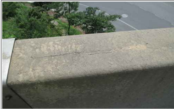
방호벽 상행선 S1 균열(폭 0.4mm)
