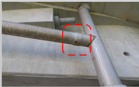
배수시설 상행선 S1 배수관 연결부 누수
