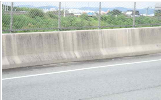
방호벽 S1 균열(폭 0.2mm)
