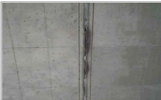
바닥판하면 상·하행선 S1 접합부 실란트 손상
