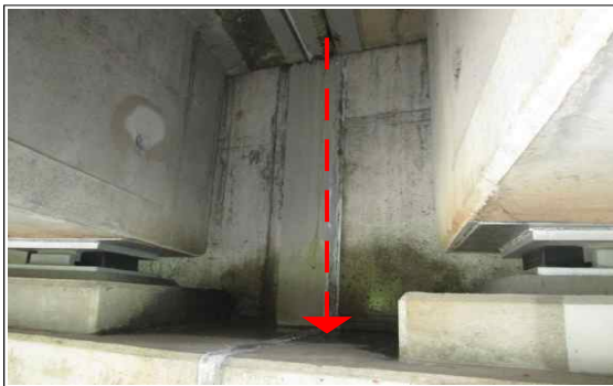
바닥판하면 상·하행선 S1 접합부 누수
