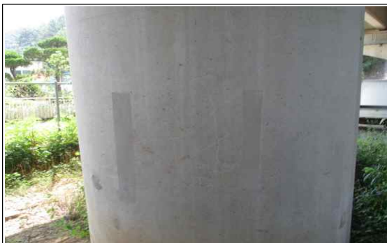
교각 상행선 P2 기둥부 배면 망상균열
