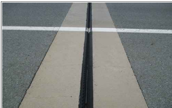
신축이음 A1 후타재 균열(폭 0.2mm)
