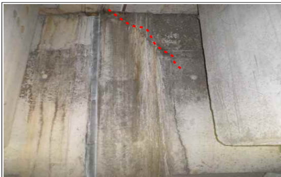
교대 하행선 A1 홍벽 균열부 백태
