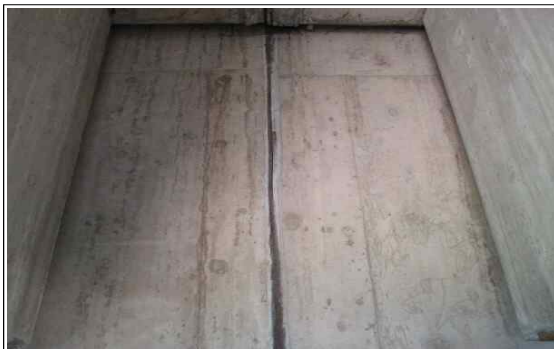
교대 상·하행선 A1 홍벽 접합부 실란트 손상
