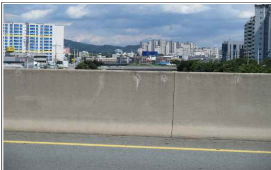
중분대 하행선 S2 균열부 백태
