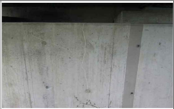
교대 A2 벽체 균열(폭 0.2mm)
