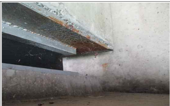
교량받침 하행선 A2 SH5 Plate 녹발생
