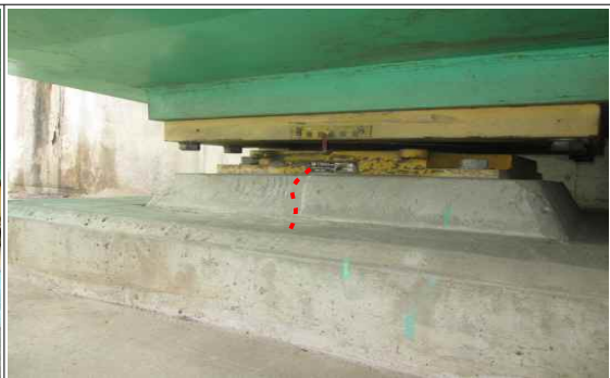
교량받침 A2-SH1 무수축물탈 균열 (폭 0.1mm)
