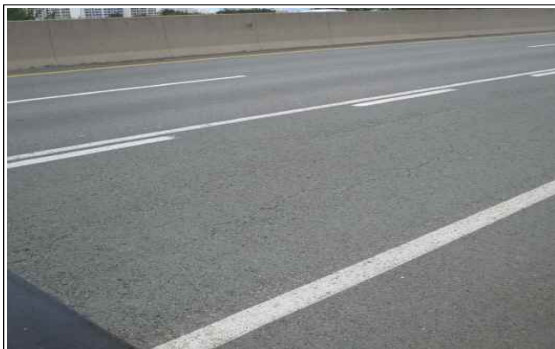
교면포장 상행선 S1 아스콘 망상균열
