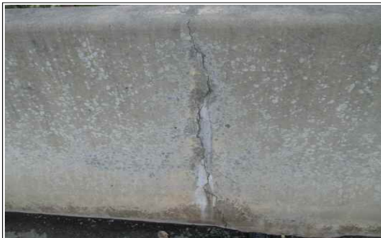
방호벽 상행선 S1 균열(폭 0.3mm)
