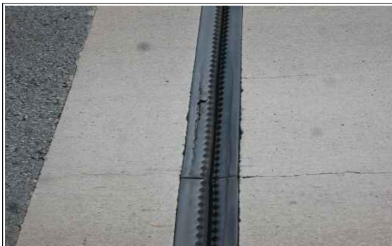
신축이음 하행선 A1 본체 고무재 손상
