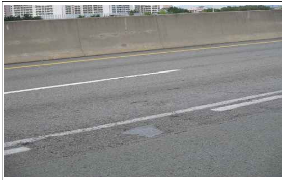
교면포장 상행선 S1 라벨링 및 패임
