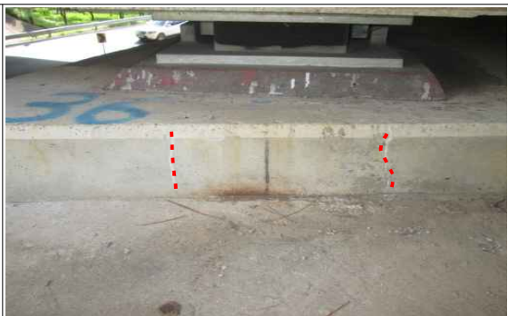
교량받침 상행선 A2 SH7 받침콘크리트 균열(폭 0.1mm)
