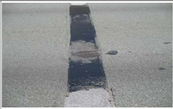
교면포장 하행선 S1(A2측) 아스콘 보수부 함몰
