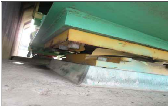
교량받침 A1-SH2 Plate 도장 들뜸
