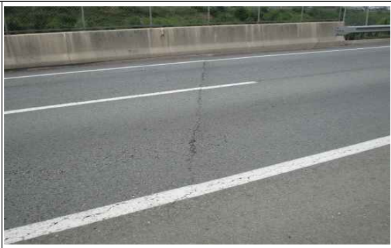
교면포장 S1 아스콘 균열
