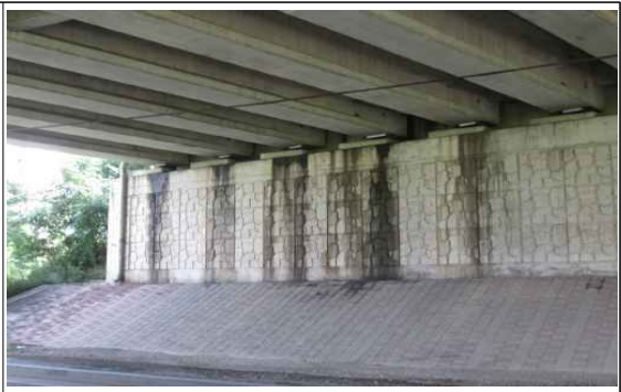
교대 상행선 A1 벽체 누수흔적
