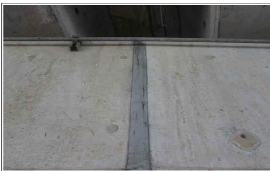
교대 상·하행선 A2 벽체 실란트 손상
