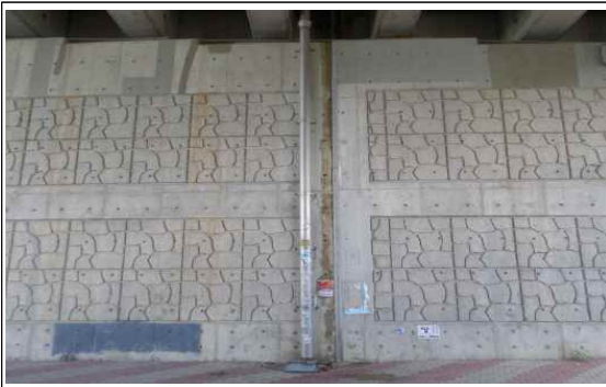
교대 하행선 A2 벽체 누수흔적
