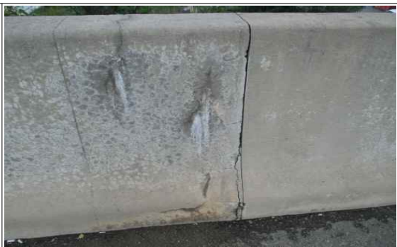
방호벽 상행선 S1 균열부 백태 및 콘크리트 손상
