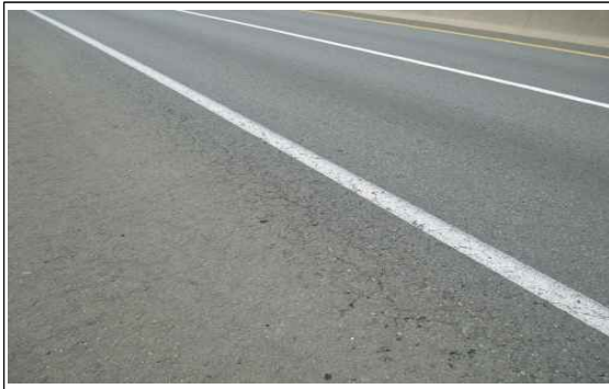
교면포장 상행선 S1 아스콘 균열
