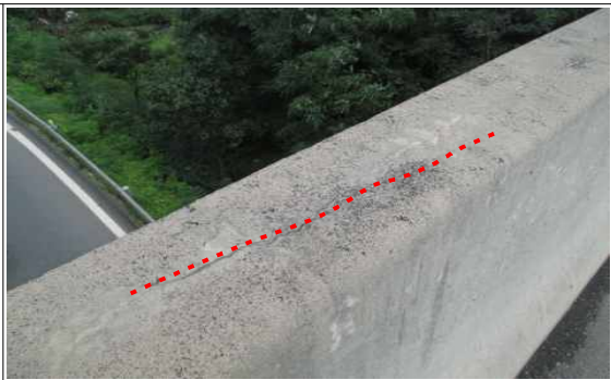
상행선 S1 중분대 균열(폭 0.2mm)
