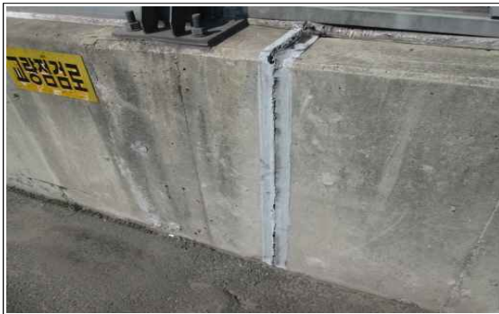
방호벽 하행선 A2측 접속도로 실란트 손상
