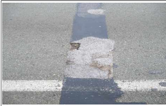
교면포장 하행선 S1(A1측) 아스콘 보수부 함몰
