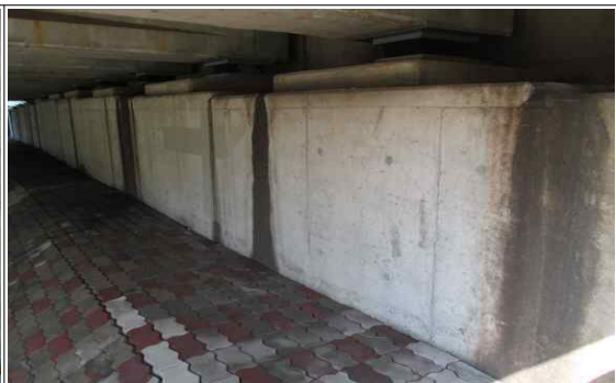
교대 상행선 A2 벽체 누수흔적
