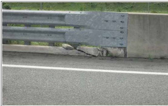
방호벽 A1측 접속도로 연석 손상
