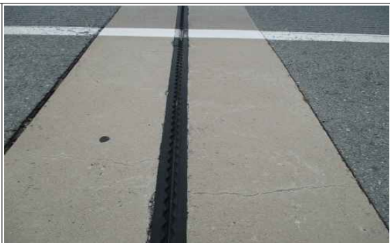
신축이음 A2 후타재 균열(폭 0.2mm)
