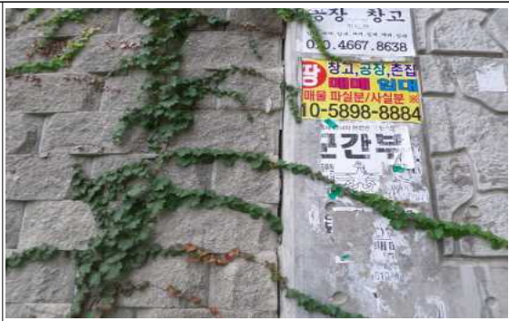
하행선 A2 벽체 옹벽 접합부 이격
