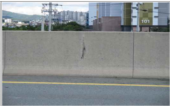
중분대 하행선 S1 균열(폭 0.3mm)
