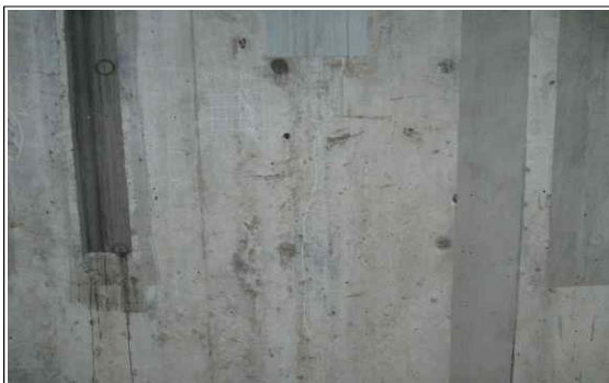
교대 A1 벽체 균열(폭 0.2mm)
