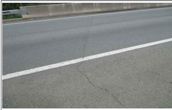
교면포장 S1 아스콘 균열
