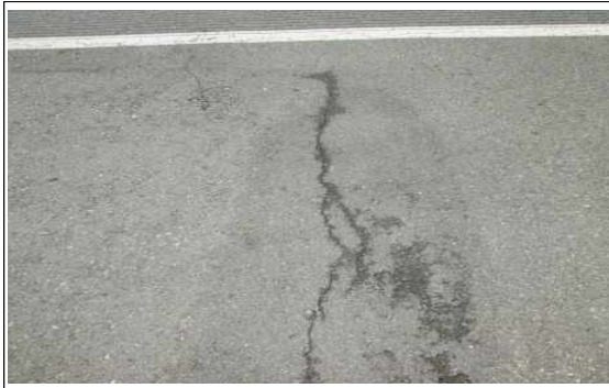
교면포장 S1-A1측 접속구간 아스콘 균열
