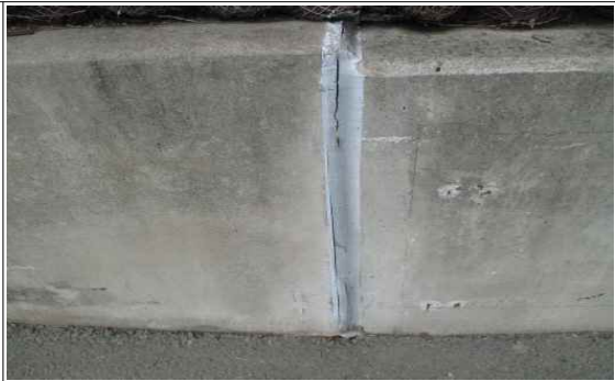
방호벽 하행선 A2측 접속도로 단차 및 실란트 손상
