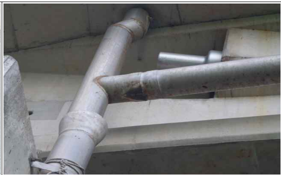
배수시설 상행선 S1 배수관 연결부 누수
