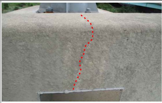
방호벽 A2측 접속도로 방호벽 균열 (폭 0.2mm)
