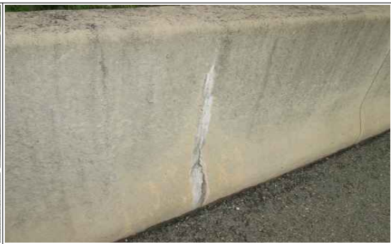
방호벽 S1 균열부 백태
