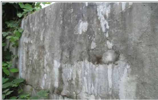
방호벽 상행선 A1측 접속도로 콘크리트 들뜸
