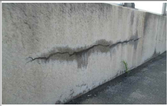
방호벽 S3 균열(폭 0.2mm)
