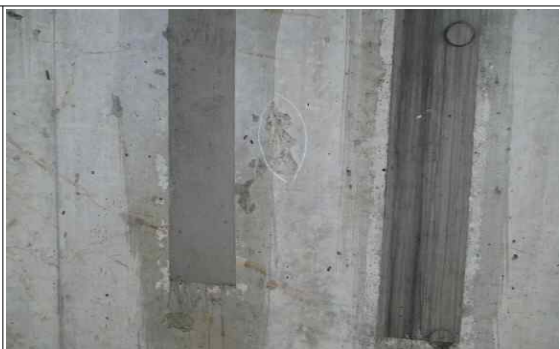
교대 벽체 A1 콘크리트 손상
