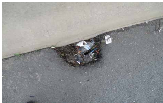
배수시설 상행선 S1 배수구 이물질퇴적
