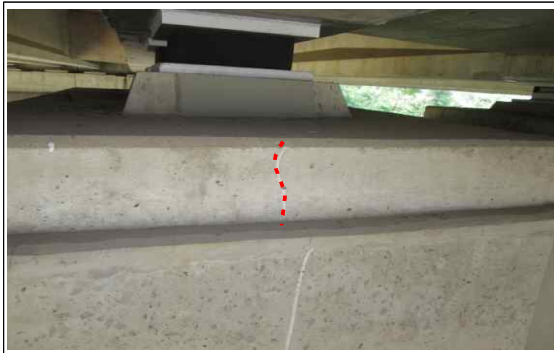
교량받침 하행선 P1 SH4 받침콘크리트 균열(폭 0.1mm)
