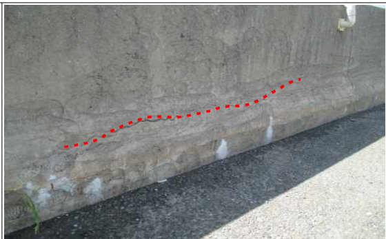
방호벽 하행선 S1 균열(폭 0.5mm)
